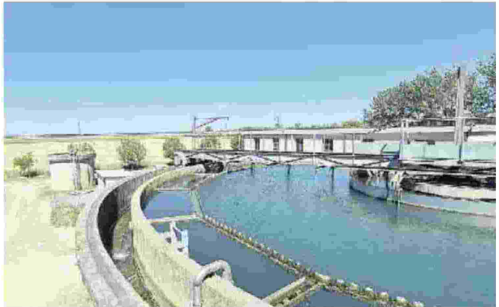
PONTE MOLO L'impianto di potabilizzazione situato in località Ca' Vendramin di Taglio di Po
