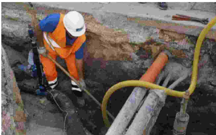
Cantiere Operai di Viacqua al lavoro per contenere le perdite della rete idrica ARCHIVIO
