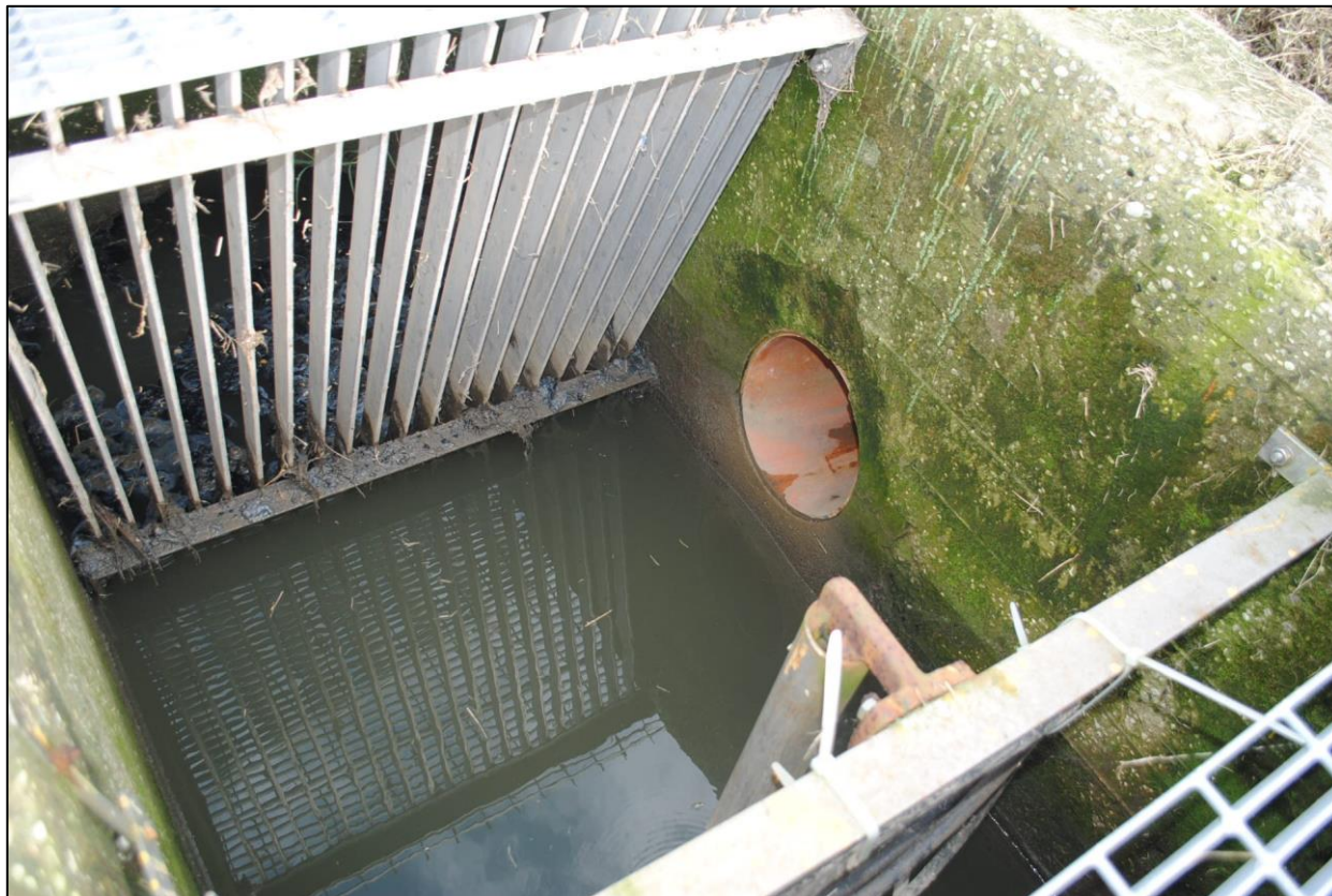
Figura 8 – Pozzetto di arrivo della rete fognaria; in evidenza la griglia fissa grossolana e lo scarico di troppo pieno
