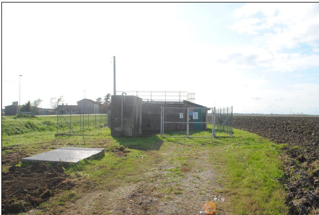
Figura 9 – Vista del depuratore: ingresso impianto
